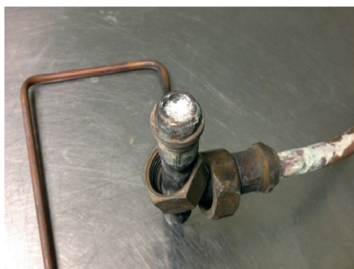
Bild 6: Verkalkung im Kühlwassersystem eines Sterilisators
