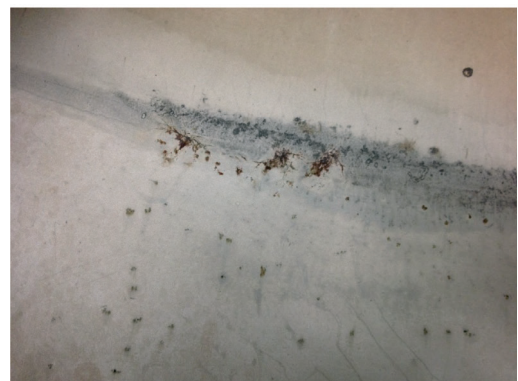
Bild 8: Korrosion an Edelstahl (oben: durch Lochfraß vollständig zerstörtes Rohr; unten: Dampfkesselblech mit deutlichem Lochfraß)
